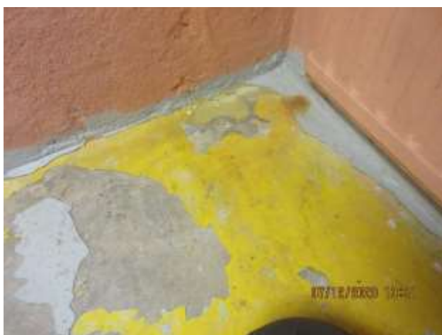
35. Näyte 13. Maali ja muut pinnoitteet, tasoite, I. krs, Pesuhuone, Lattia
