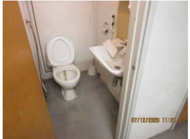
10. Näyte 4, toisen kerroksen wc:n seinästä muovimattoa ja liimaa
