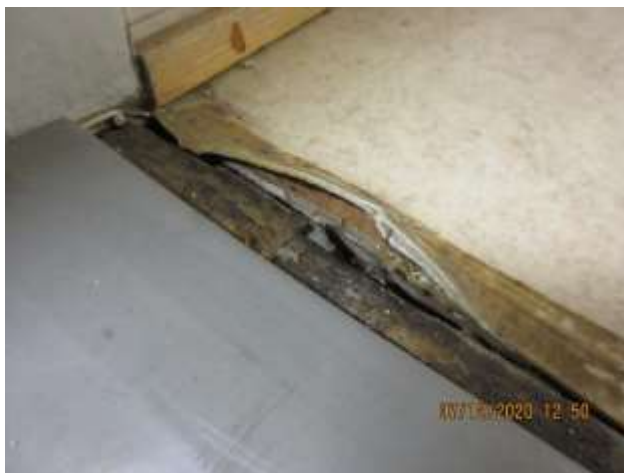
27. 2 krs kokoushuoneen kynnyks, kokoushuoneen lattia on puulevy alustainen, käytävän lattiassa on mustaliima
