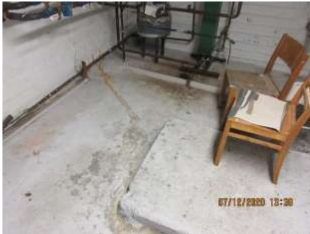
37. ja 38. Näyte 17. Maali, Lämmönjakohuone, Lattia
