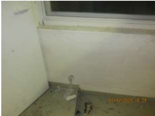
7. Näyte 2, länsipään hallin seinämaalaa ja tasoitetta
